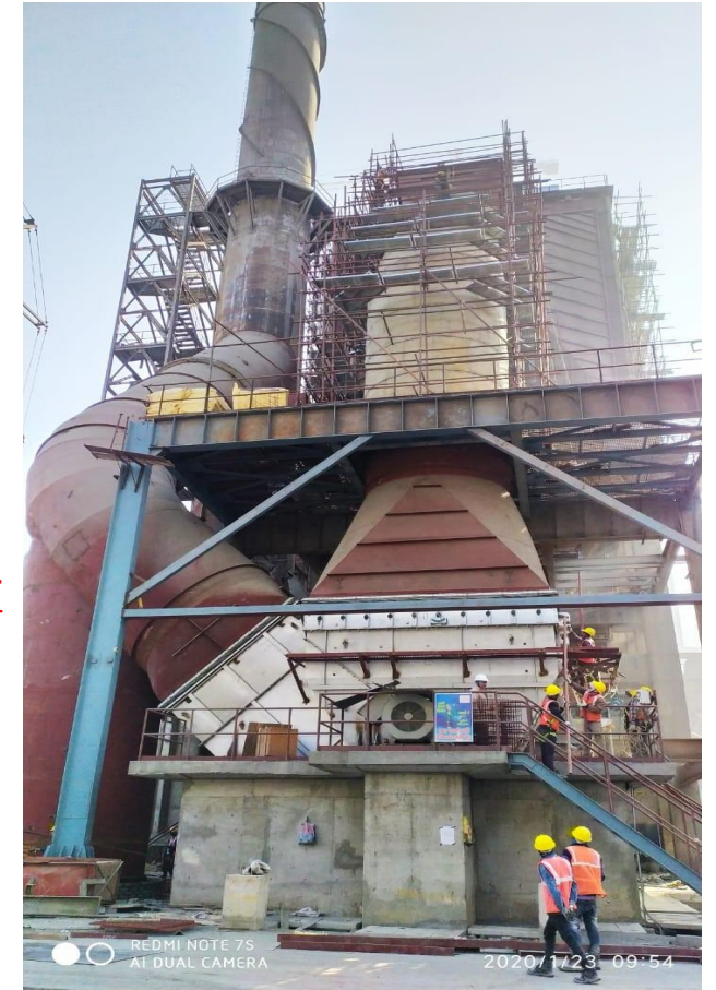
Clinker Cooler ESP Vent Fan
